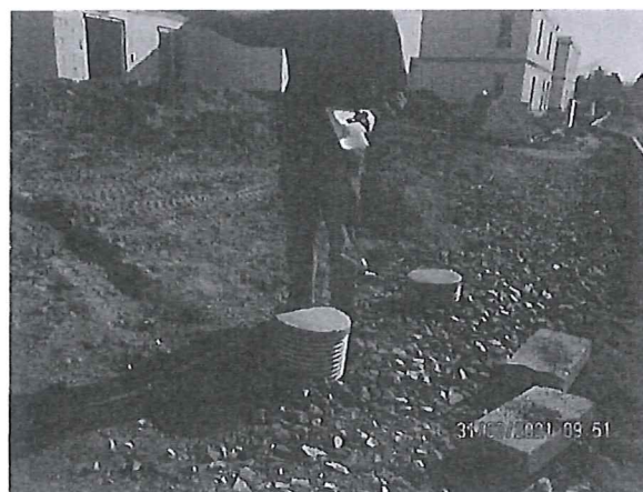
Foto č. 8 - propojovací plastové potrubí je provedeno v nedostatečném krytí, z nevhodných materiálů a revizní šachtice s nesystematických částí. Vše v rozporu s PD.
