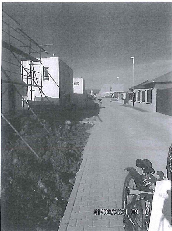
Foto č. 1 - Odvodňovací prvky a projektované příkopy jsou zasypány.
