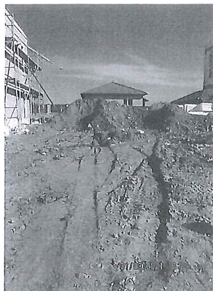
Foto č. 10 - Na propojovacím potrubí uloženém s minimálním krytím, pojezdí těžká stavební mechanizace a jsou zde uloženy násypy výkopků. Potrubí může být tímto způsobem poškozeno.
